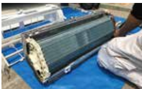
エアコン洗浄
