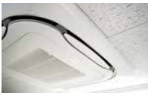
空調機器(店舗・事務所)
