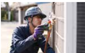
エアコン保守・メンテナンス
