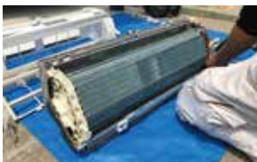
エアコン洗浄
