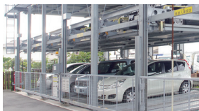
立体・機械式駐車場設備
