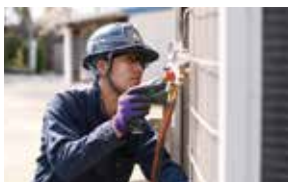
エアコン保守・メンテナンス
