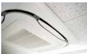
空調機器(店舗・事務所)
