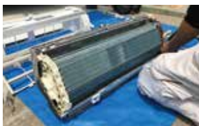
エアコン洗浄
