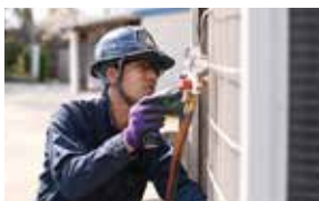
エアコン保守・メンテナンス
