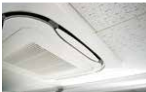
空調機器 (店舗・事務所)
